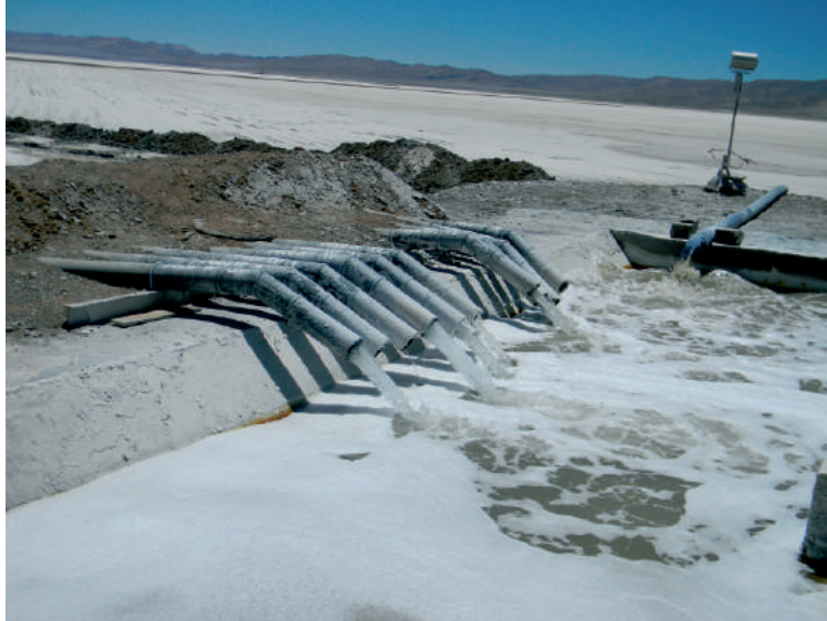
Figura 2. Tuberías para el traslado de la salmuera desde los pozos de extracción hasta los piletones de decantación. Proyecto Sales de Jujuy. Foto: Nelly V. Rodríguez.
